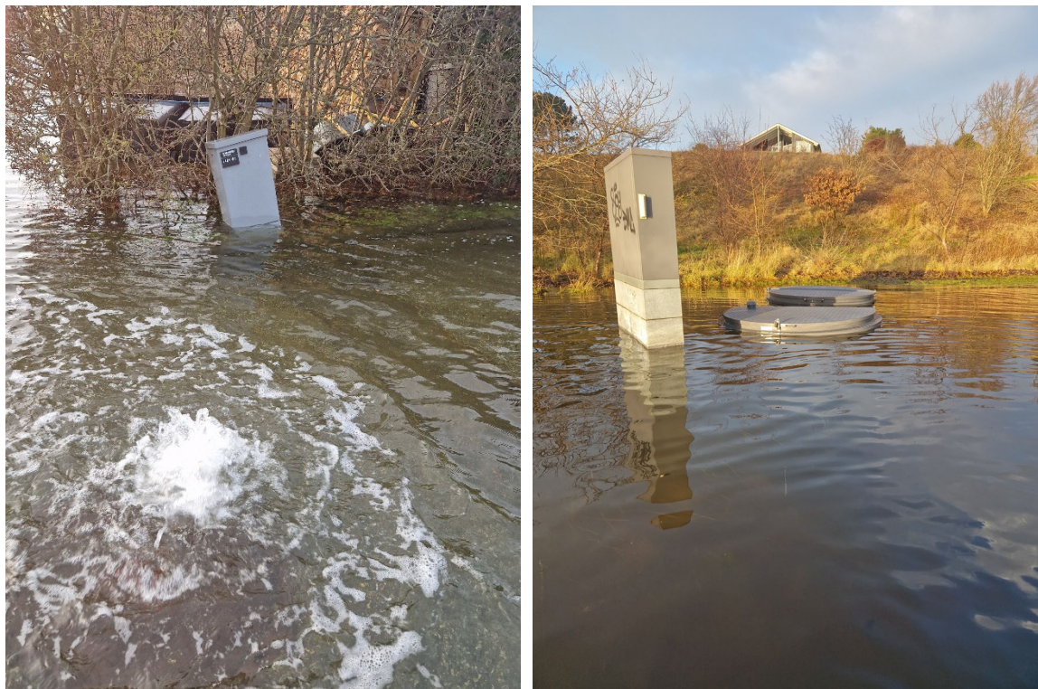
Figur 38: Oversvømmelse af Smedeengen Pumpestation (tv) og Vigvejen Pumpestation (th) i Frederiks-sund Kommune 22. december 2023.
